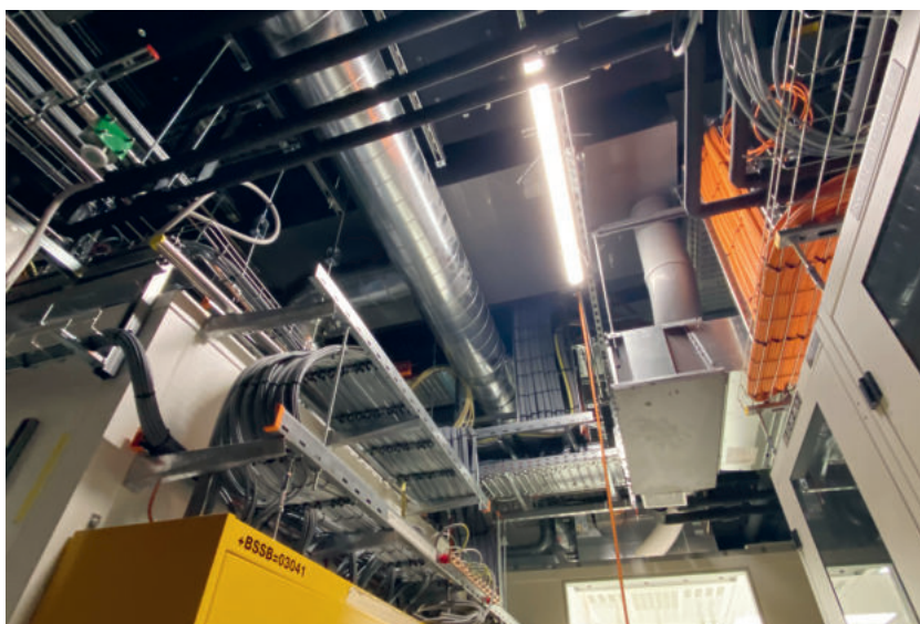
Technikinstallationen über dem Reinraum.
